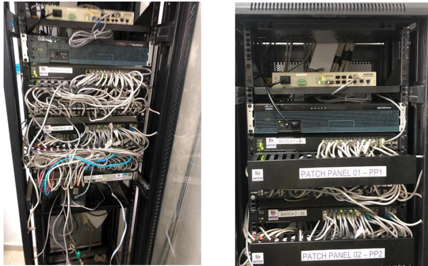
Imagen 22. Rack principal después del mantenimiento preventivo
